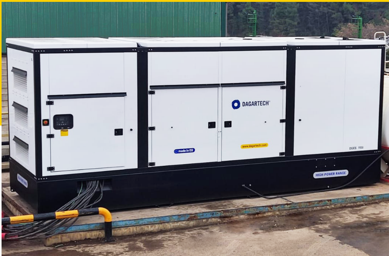
Grupo electrógeno Dagartech instalado en la planta de reciclado de Gandesa, Tarragona.
