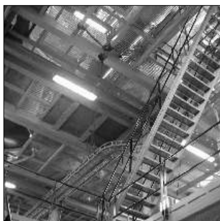
Suelos de rejillas de doble pletina vistos desde abajo.
