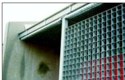
Pared exterior de rejillas de pletina de la Instalación Geotérmica de Thisted, Dinamarca
