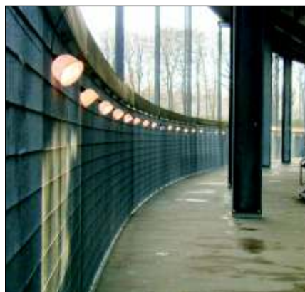
Pared de rejilla con iluminación montada
