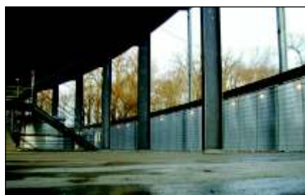
Las rejillas de pletina de mallas grandes
