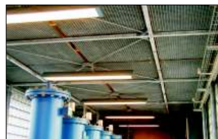
Techos enrejados de la instalación Geotérmica de Thisted, Dinamarca
