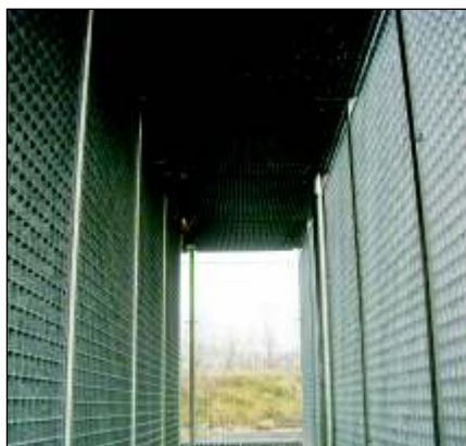
Paredes de rejillas de la instalación Geotérmica de Thisted, Dinamarca.
